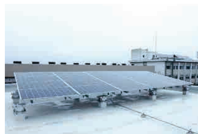
太陽光パネル
